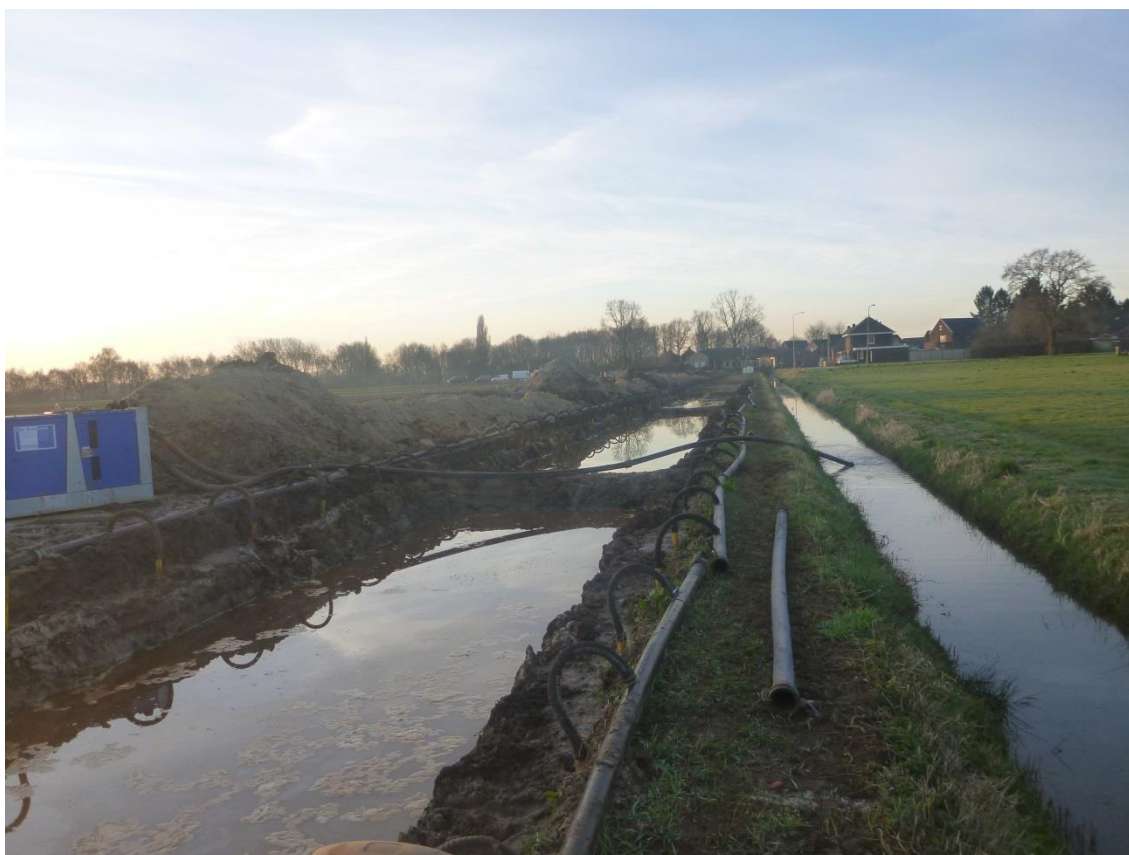
Figuur 14. Huidige situatie met links de (volgelopen) sleuf voor de persleiding en rechts de recentelijk gegraven sloot.
