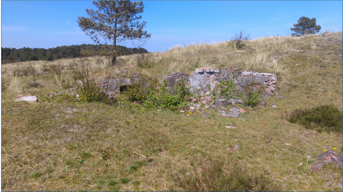
Figuur 6. Het zwaar beschadigde gemetselde bouwwerk binnen Widerstandsnest 20, midden op de Zwarte Blink.
