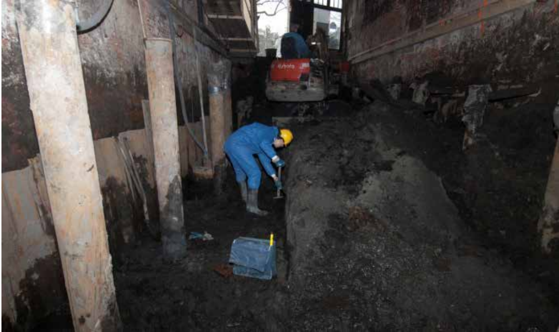
59 In het centrale deel van het pand kon, nadat de bovengrond van grijs zand met puin (S 1) was verwijderd over een beperkte diepte een bodemprofiel worden gedocumenteerd
