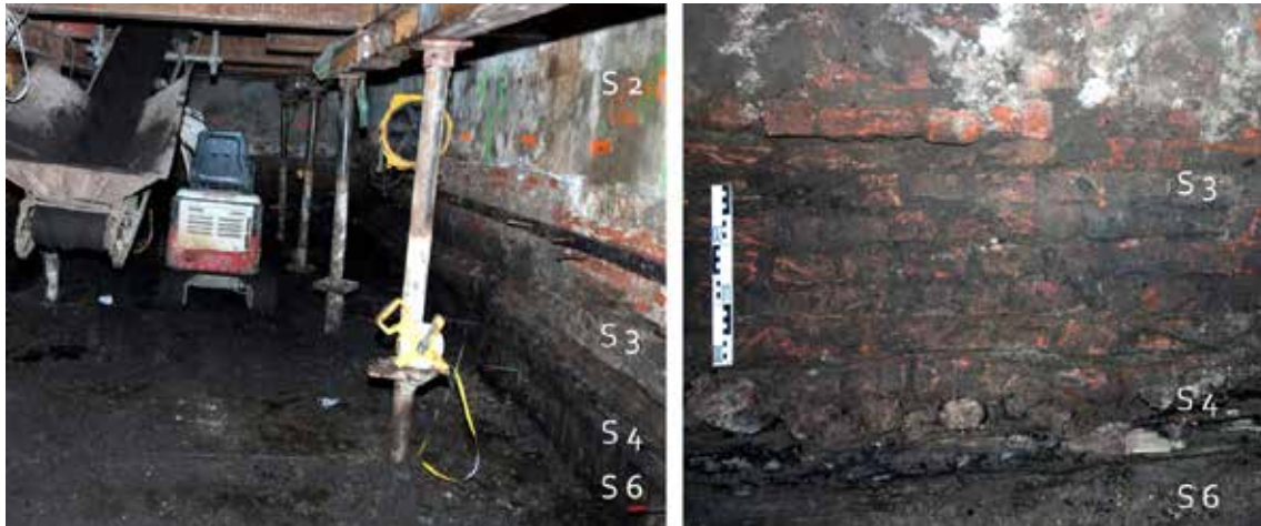
26 Links: de ontgraven ruimte gezien richting de voorgevel met het niveau van de hoofdsporen langs de linker zijgevel, rechts: de staalfundering van muurwerk S 3 was opgebouwd uit liggende stammetjes (S 4) geveild in zand op de ophoging S 6
