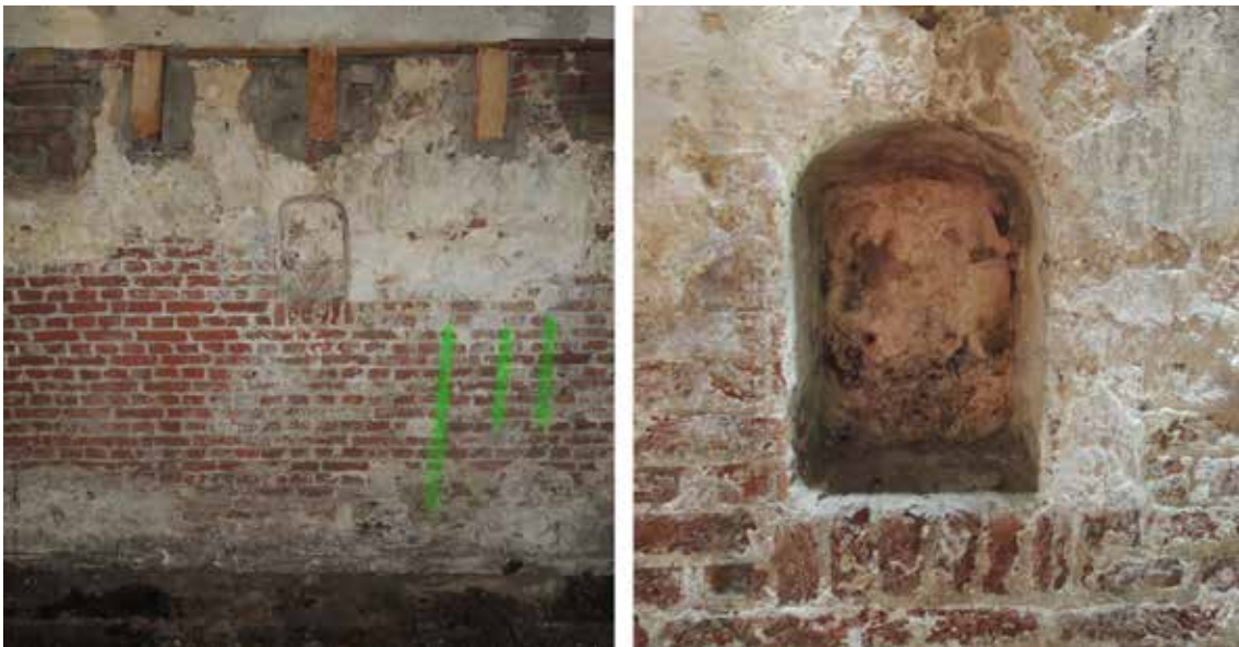
11 De rechterbouwmuur van de kelder (S 2) met een van de drie kaarsnissen en bovenin de restanten van de vloerbalken van de begane grond, rechts detail van een kaarsnis met de, voor Amsterdam typische, halfcirkelboog
