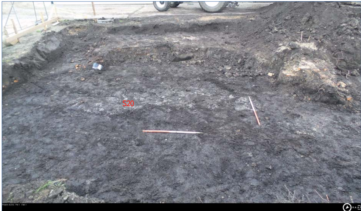
Figuur 8. Vlijlaag afgebroken fundering zijgevel (spoor 20).
