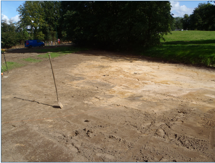
Figuur 3. Zandopduiking (kop) ter plaatse van oeverzone 1.
