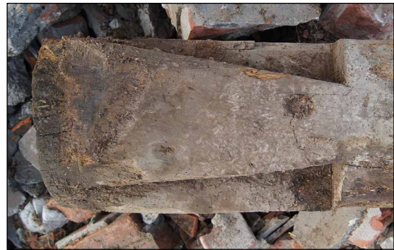
Afb. 84 Zwaluwstaartvormige uitsparing in de bovenkant van de westelijke dekbalk.
