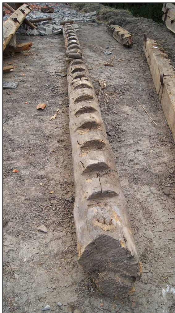
Afb. 88 De ronde overstekbalk aan de westzijde. In de kleine inkepingen lagen de daksparran.
