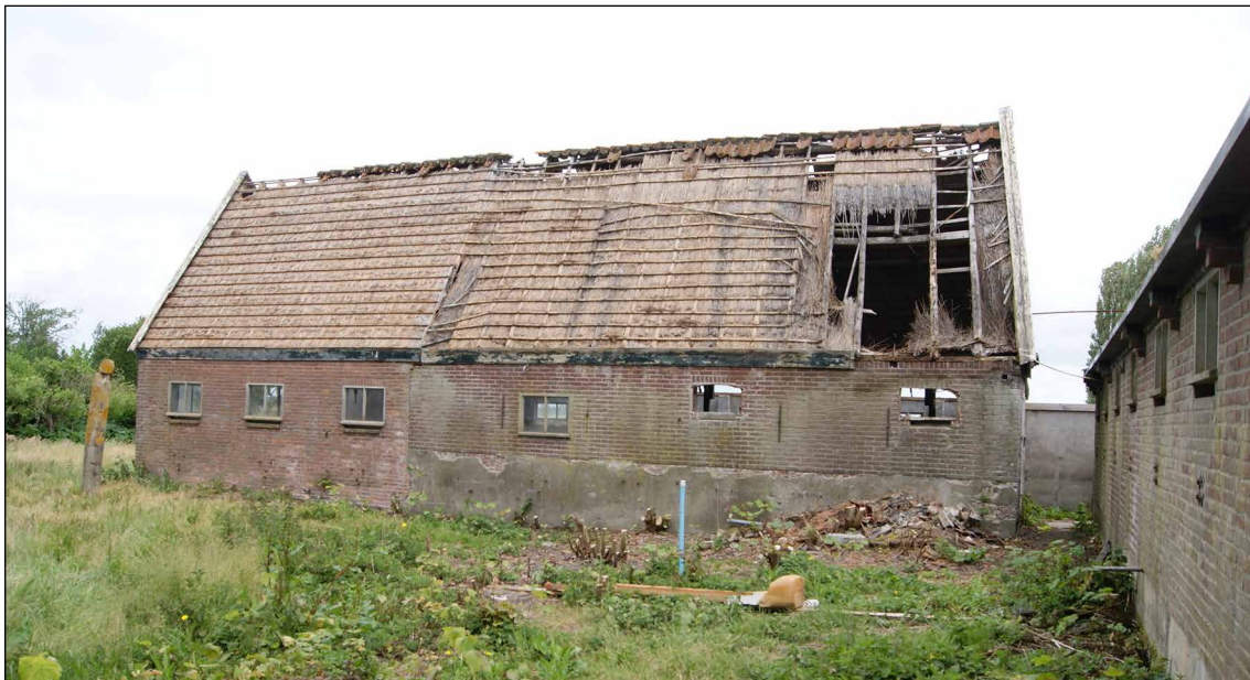
Afb. 71 De schuur schuin achter de boerderij. In het metselwerk zijn twee bouwfases herkenbaar.
