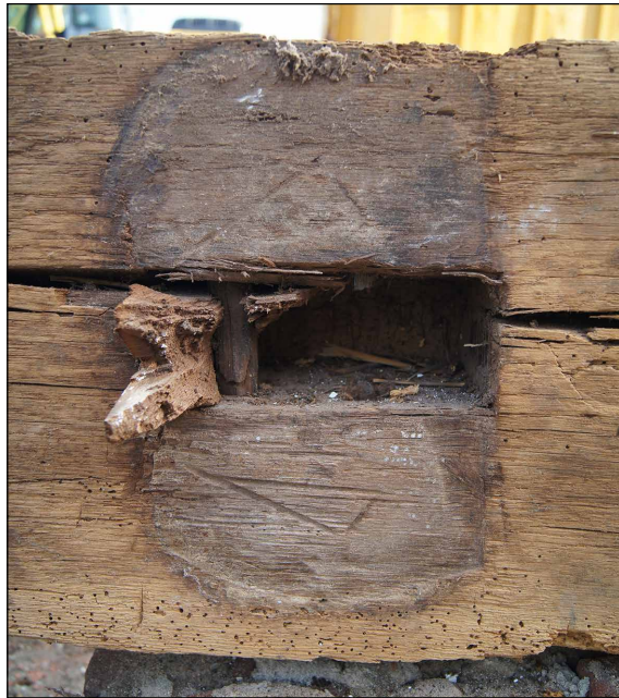
Afb. 77 Rechthoekig pengat in de onderkant van een dekbalk. Op deze plek is tevens een handelsmerk zichtbaar.
