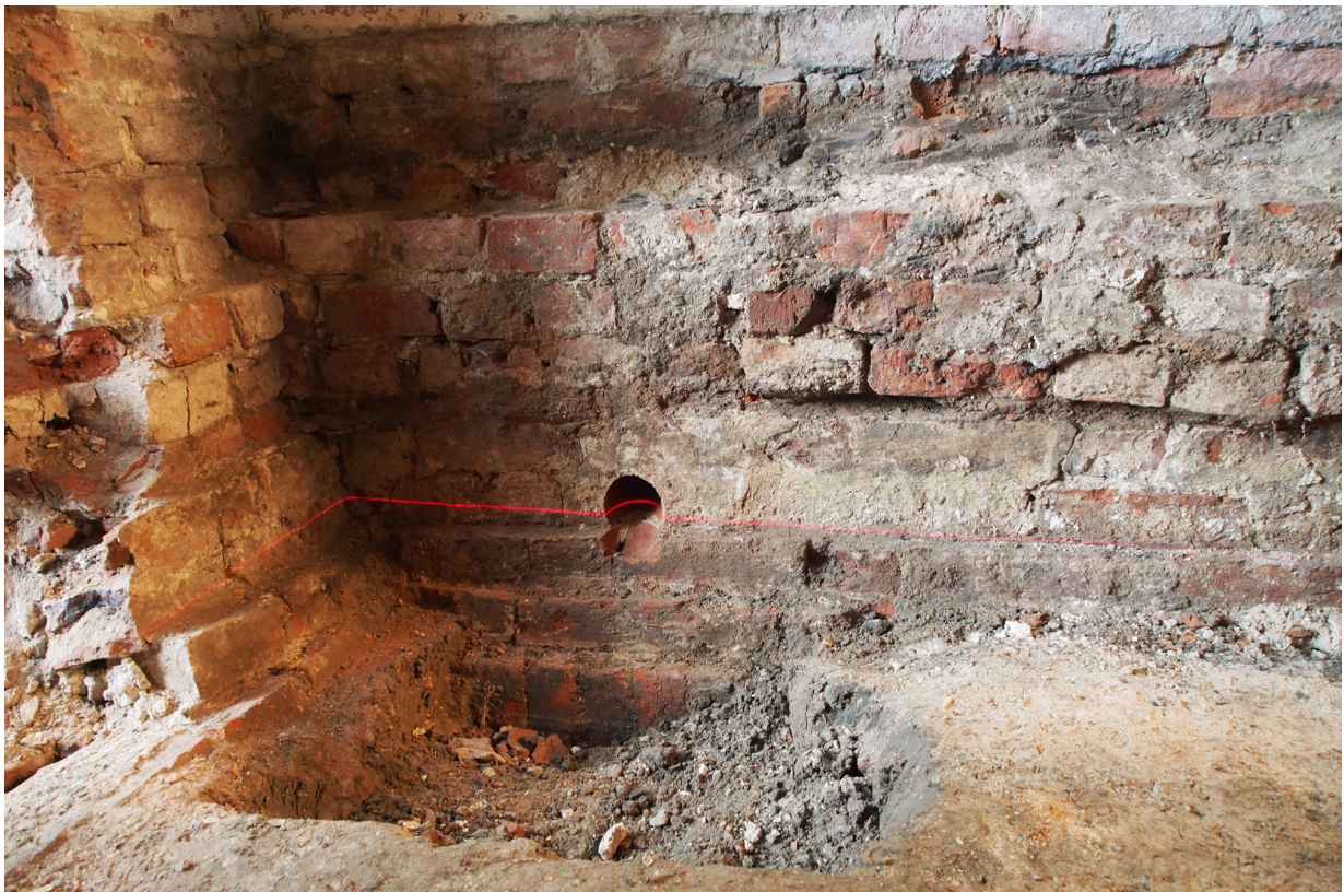
Afb. 26 Binnenkant fundering noordgevel. De fundering komt overeen met die van de zuidgevel van de toren. Het muurwerk is duidelijk naar het westen gezakt zoals te zien is aan de laserlijn.
