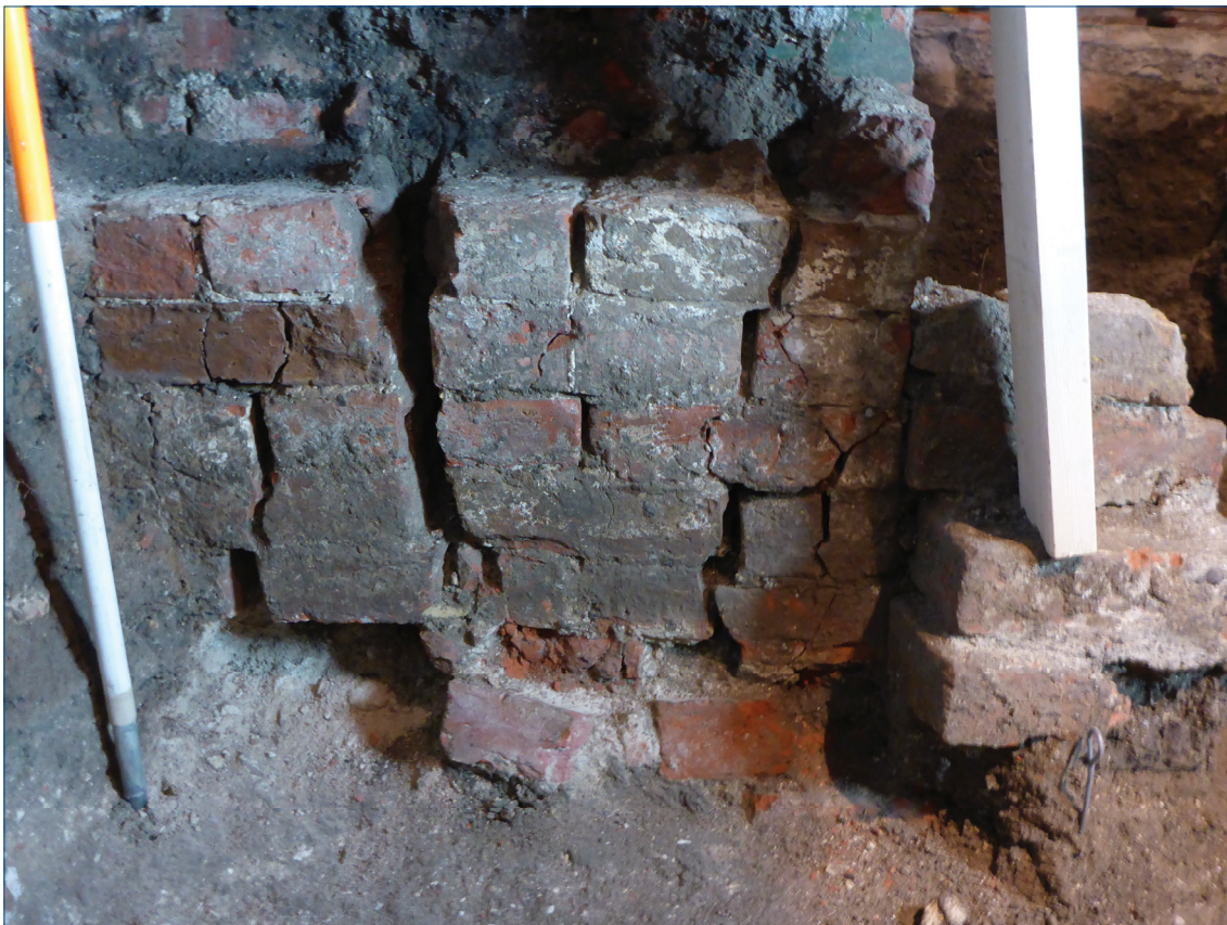
Figuur 5. Scheuren in de middeleeuwse fundering.
