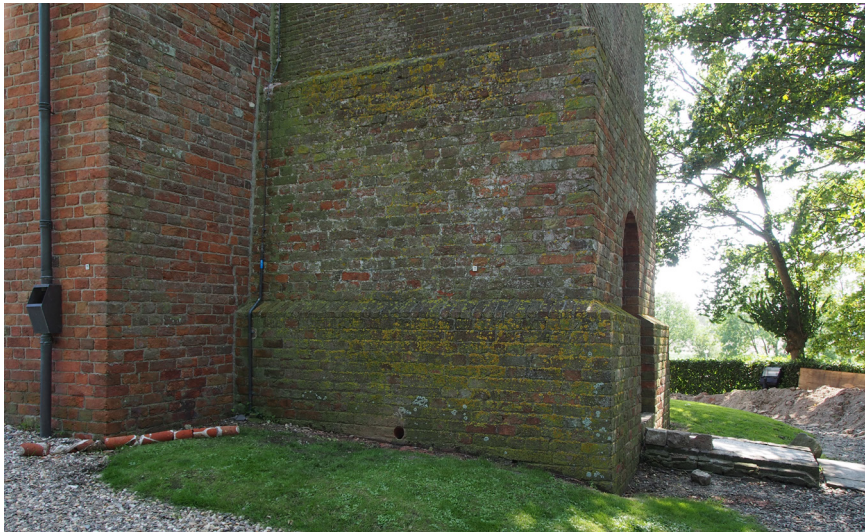
Afb. 19 De noordgevel. ten tijde van de waarneming. De buitenschil van de sokkel is geheel vernieuwd. Daarboven zit aan de noordkant nog deels oud metselwerk.
