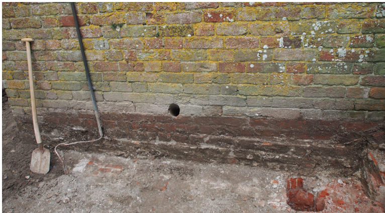
Afb. 42 Fundering zuidgevel toren buitenkant. Voor de gevel ligt een fundering van mogelijk 18de-eeuwse steen.
