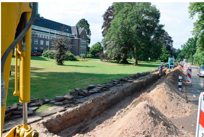
Figuur 3. Impressies van de werkzaamheden in de Kerkstraat. 1 het begeleiden van de aanleg van een huisaansluiting ter hoogte van huisnummer 74; 2 gegraven leidingsleuf aan de westzijde van de straat, in het meest noordoostelijke deel van het plangebied; 3 het ontgraven van de oude gesleiding aan de oostzijde van de straat.
