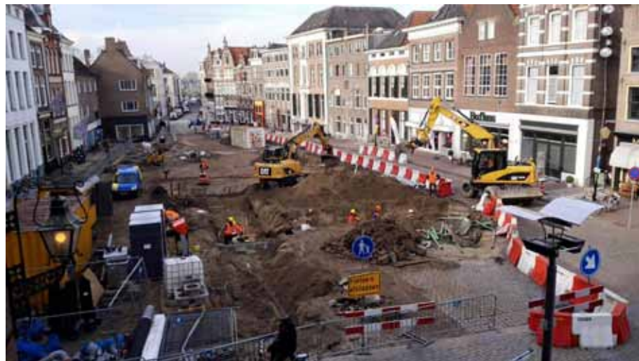
2. De Groenmarkt op de schop, gezien vanaf de Wijnhuistoren. Hier worden kabels- en leidingen gelegd, er wordt bestraat en er vindt archeologisch onderzoek plaats.
