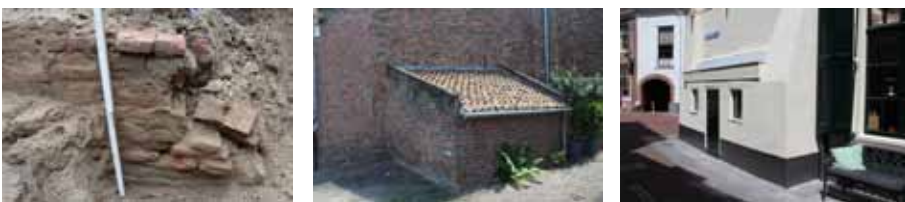
12-14. Links: muurwerk bij Groenmarkt 4, mogelijk resten van een pothuisje. Daarnaast als voorbeeld nog bestaande Zutphense pothuisjes in de Proostdijsteeg en Korte Beukerstraat.
