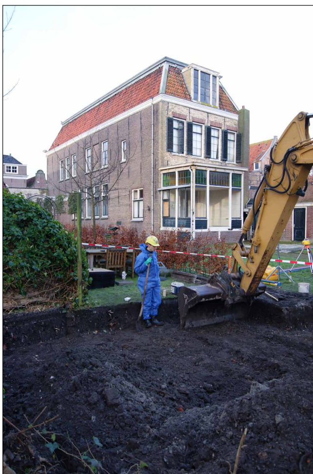
Afb. 12 De graafwerkzaamheden in volle gang. Op de achtergrond de achterkant van een pand dat aan de Breedstraat staat.
