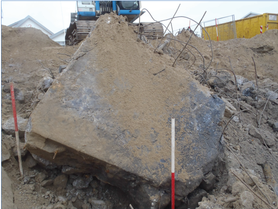
Figuur 6.4. Omgevalen betonnen deel van de bunker (S 2).
