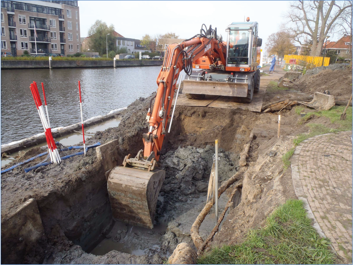
Figuur 2. Impressie van de werkzaamheden in het zuidelijke deel van de sanering.
