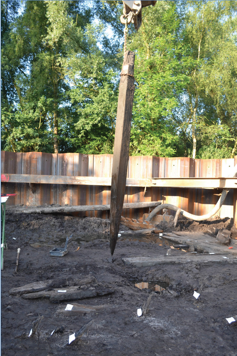
Figuur 13. Een dragende balk van het verdeelwerk (lengte 4,3 m).
