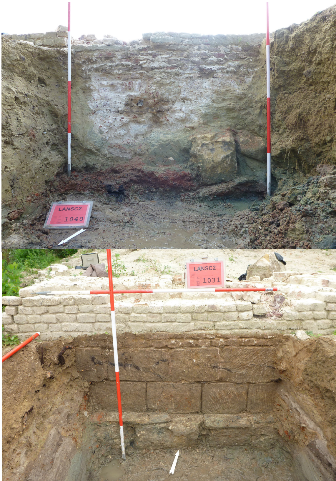
Figuur 8.3 De zuidelijke landhoofdmuur. De noordzijde van deze muur (boven) was relatief onregelmatig en slordig opgebouwd. De zuidzijde daarentegen (beneden) kenmerkte zich door verzorgder metselwerk.
