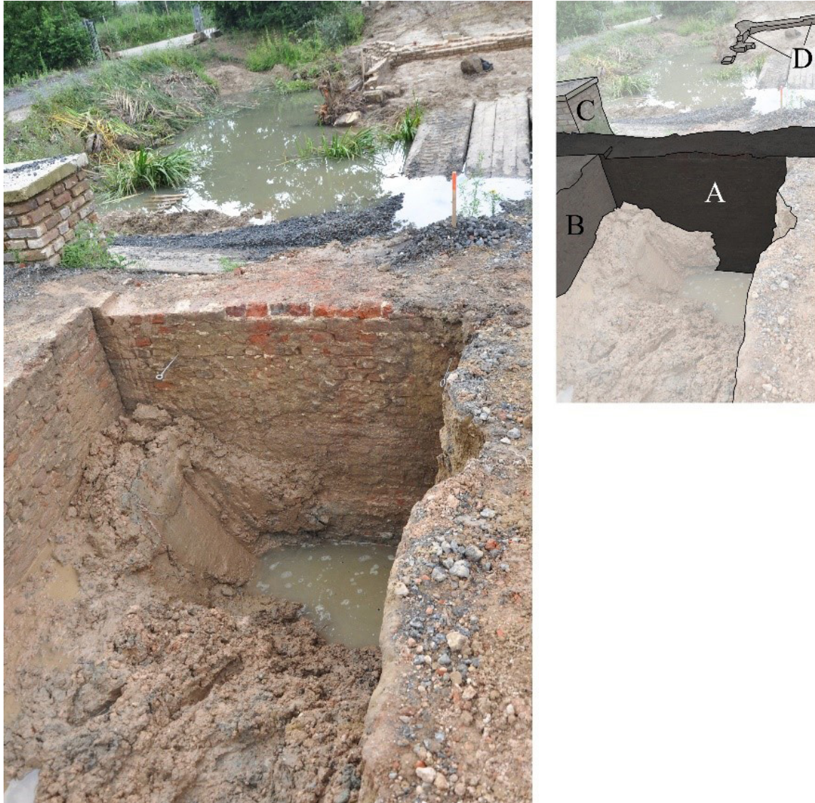
Figuur 9.26 Detail van de noordwesthoek van het poortgebouw. Bij A de noordmuur, die tevens de scheiding met de gracht vormt. De westwand van de poort (B) is hier koud tegen geplaatst. Gezien de overeenkomst in mortel en baksteen zullen beide tot dezelfde bouwfase behoren. Er zal sprake zijn van een uitvoeringsfase, waarbij in eerste instantie de buitengevels tot het niveau van het maaiveld zijn opgetrokken en kort erna de funderingen van de bebouwing van de bouwhoeve. Het metselwerk bij C geeft de plaats aan waar bij de consolidatie in de jaren zeventig van de vorige eeuw de plaats van de buitengevels is aangegeven. Op de achtergrond is bij D het bruggenhoofd zichtbaar. Zowel bij de west- als bij de oostmuur is de insteek aangetroffen, die afkomstig is van een relatief hoog niveau. Bij de noordmuur is geen insteek aangetroffen. De voorlopige hypothese is dat in eerste instantie de buitengevels zijn aangelegd en dat daarna het terrein is opgehoogd, om vervolgens de overige muren van de voorburcht op te trekken. In ieder geval is duidelijk dat bij de bouw van de huidige voorburcht in 1650 het terrein fors is opgehoogd. Onder het ophogingspakket is in het westprofiel het restant van de muur aangetroffen waarvan de overige delen in het verleden door de TH Delft zijn vrijgelegd. Dit restant bestaat uit een houten balk, met daarop nog één laag natuursteen en daarop plaatselijk baksteen. Aansluitend op deze restanten bevindt zich een donkere laag, die of een beekbodembodem, dan wel het restant van de gracht is geweest. De westmuur van de poort is mogelijk dieper aangelegd, omdat de aansluitende ruimten onderkelderd waren. Mogelijk is dat ook de reden waarom de voorganger ter plaatse van de poortdoorgang zo diep is uitgebroken.
