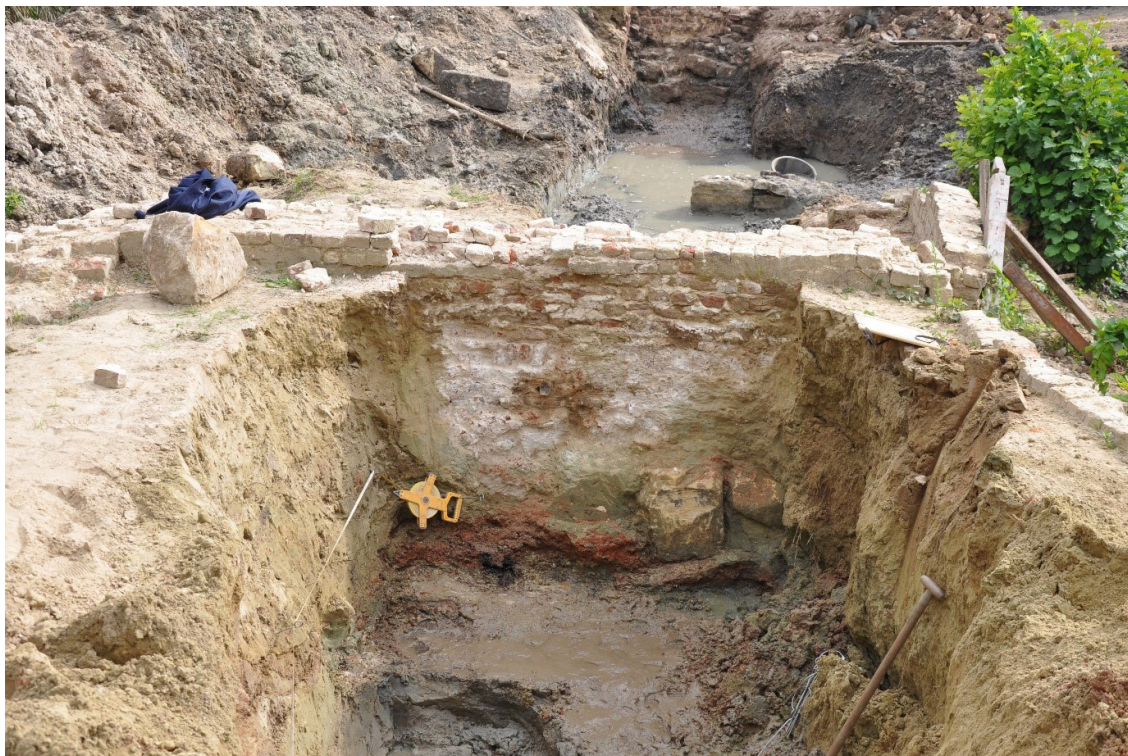
Figuur 9.8 Detail van de binnenzijde van het bruggenhoofd. Het metselwerk is hier voorzien van een zeer harde laag mortel. Het metselwerk zelf is onregelmatig en slordig uitgevoerd.
