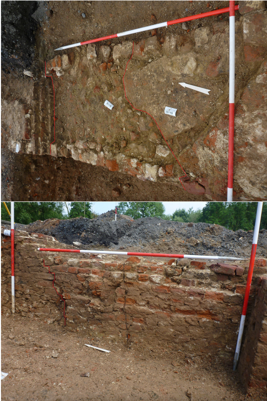
Figuur 7.7 In het zuidelijke deel van de oostelijke torenmuur wijkt het metselwerk af ten opzichte van de rest van het poortgebouw (boven). Het metselwerk bestaat hier uit een uit een soort kistwerk met aan de buitenzijden een halve steen metselwerk. Het verschil in metselwerk tekent zich ook in het aanzicht van de muur af (beneden).
