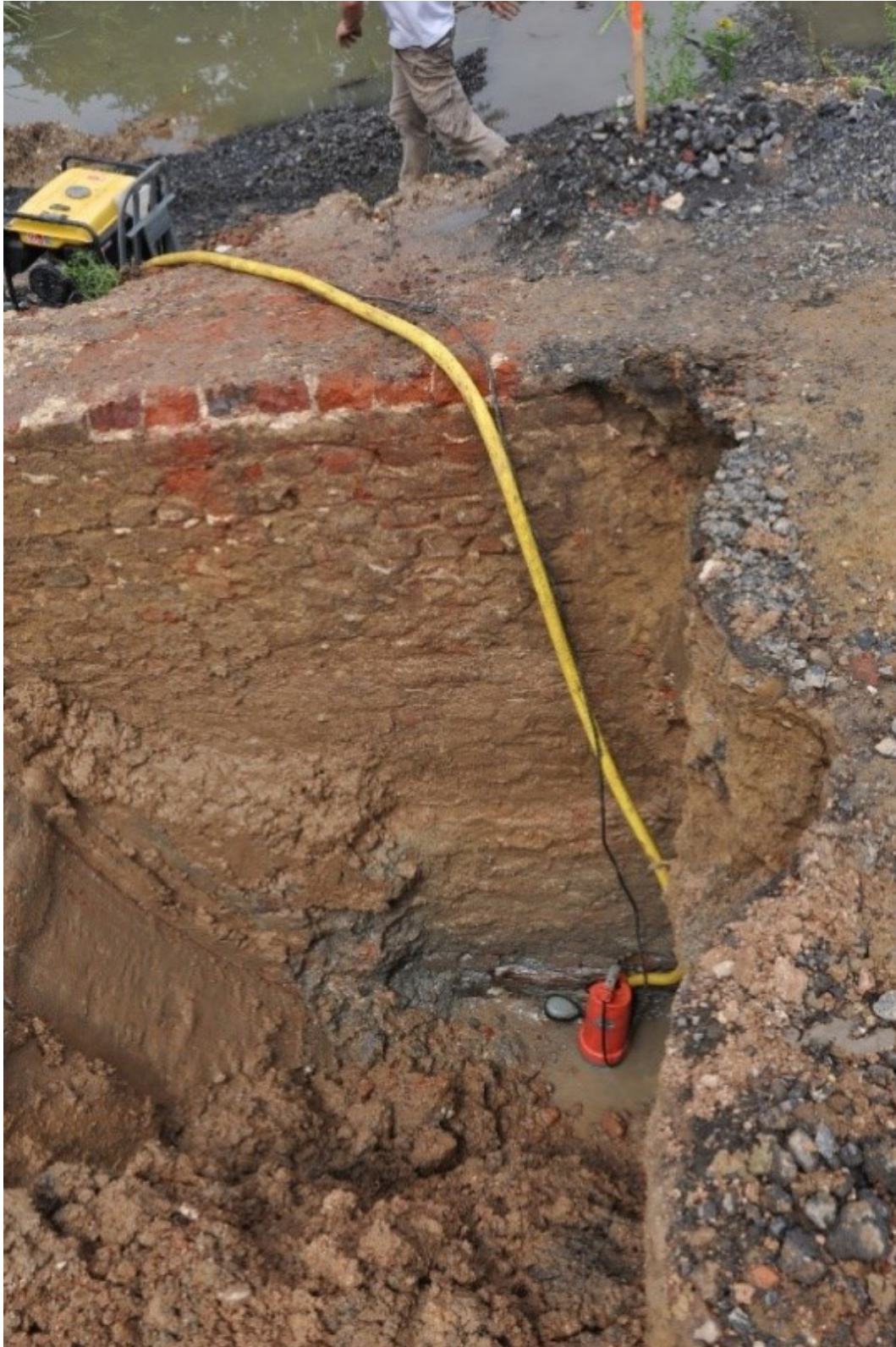
Figuur 9.27 Detail van de fundering van de noordmuur. Geheel aan de onderzijde is bij de waterpomp nog net een houten balk zichtbaar, waarop het metselwerk is geplaatst. Vermoedelijk zijn onder deze plaat houten funderingspalen geplaatst.
