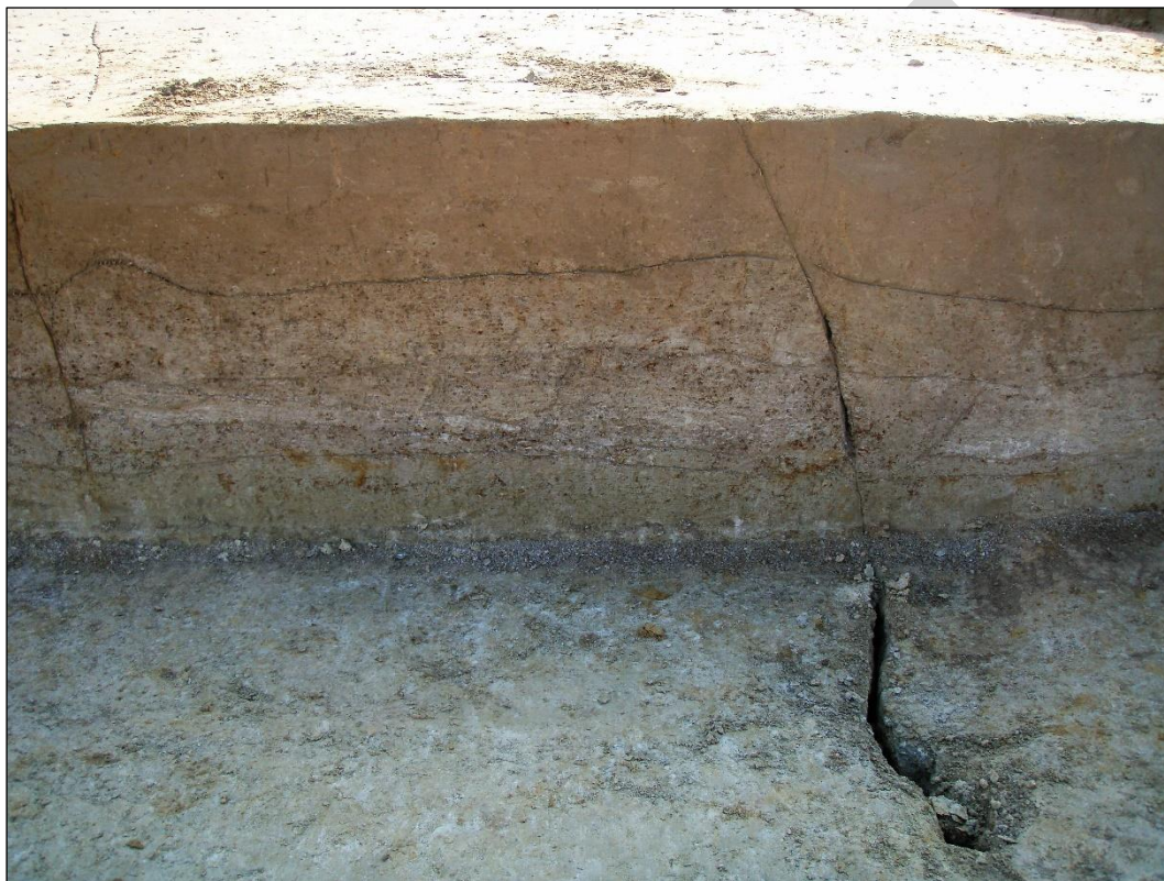
Afb. 22. Scheur als gevolg van verzakkingen door mijngangen in de ondergrond.
