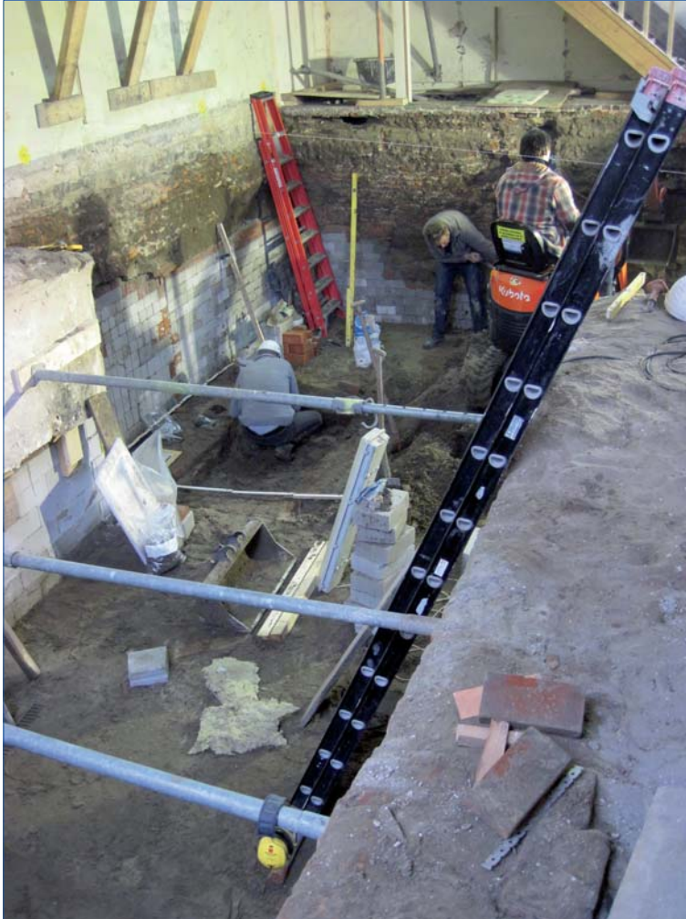
Figuur 3. Indruk van de werkzaamheden. Op de voorgrond is de oude kelder reeds uitgegraven en gestempeld. Daar achter het uitbreiden van de oude kelder in zuidelijke richting.
