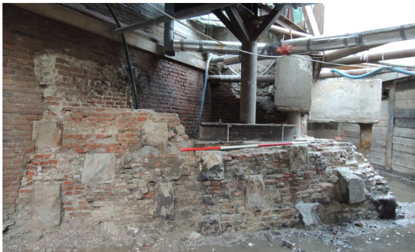
32 Veldzijde van de noordelijke stadsmuur in 2014. Links is te zien dat de buitenste schil van het metselwerk van het muurvlak van de poort in 1993 geheel is ingeboet
