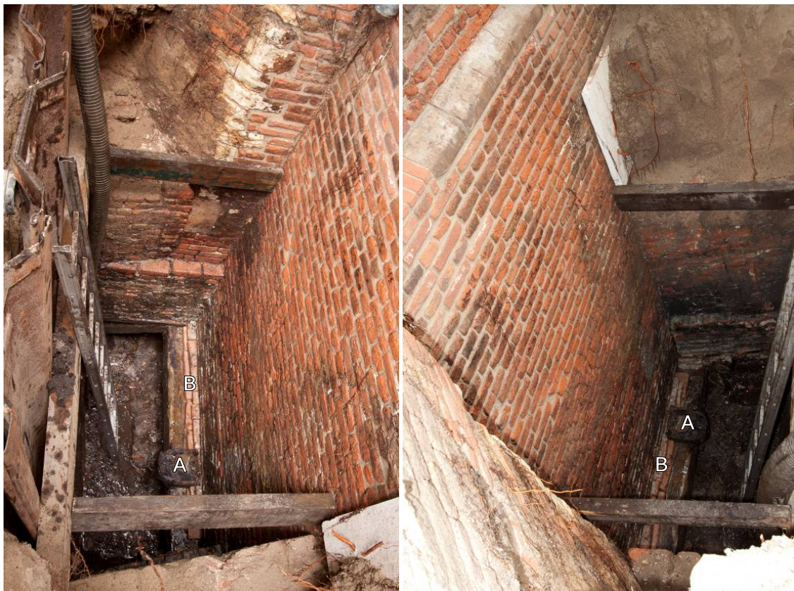
51 Links: De westgevel van de poort (rechts) gezien richting Sint-Lucastoren (boven). Rechts: De westgevel (links) en de stadsmuur (boven) bij het funderingsonderzoek van 2011. Goed zichtbaar is de uitstekende balk van de roosterfundering (WAAG2-1)
