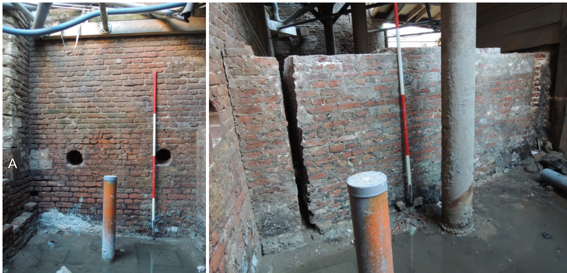
50 Links: Westgevel aan de stadszijde van de stadsmuur. Rechts: De stadsmuur gezien vanaf de stadszijde
