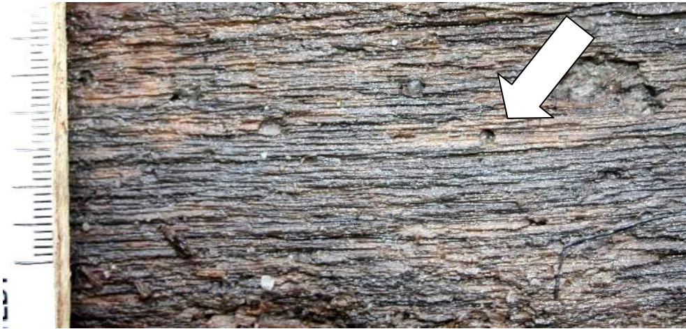
Figuur 27 Bunnik-Achterdijk, detail van eiken paal met houtwormvraat in het spint, middelste palenrij van brug, spoornummer 976 (©Silke Lange).
