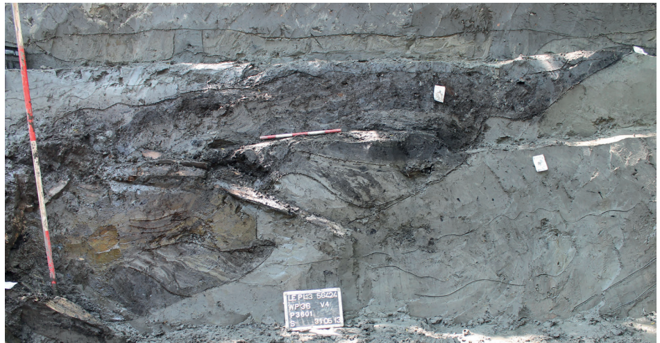
Fig. 7.43 Met mest en huisvuil opgevulde funderingssleuf van STR 608 en 611 in het westprofiel van WP 36. Vergelijk profiel 36.01 (fig. 5.7).
