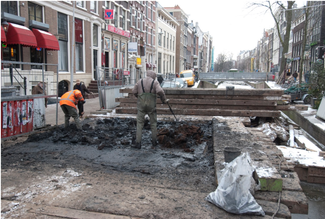
11 Nadat het slib van de grachtbodem en het venige ophogingsmateriaal op schotten op de bouwkuip was uitgestort kon deze worden doorzocht op vondsten
