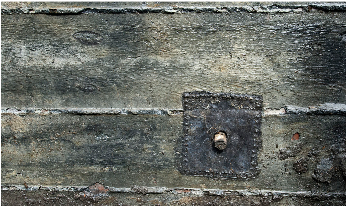
47 De onderzijde van waterkelder S 160 met daarin een loden plaat en houten stop
