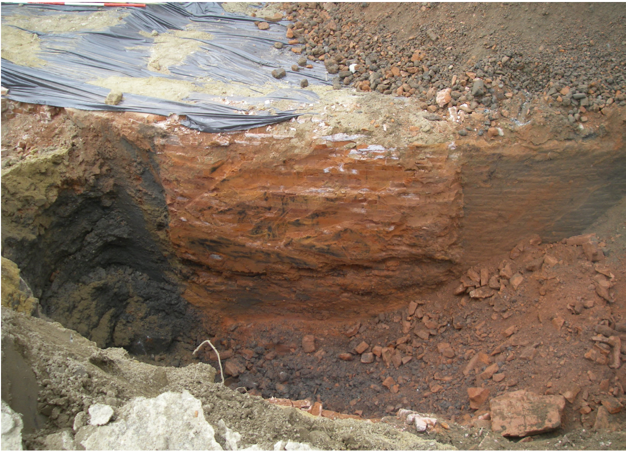
Figuur 4.29. Diep uitgegraven Rode Toren met onderin de houten fundering (raamwerk bestaande uit balken en planken) van circa 40 cm dik.
