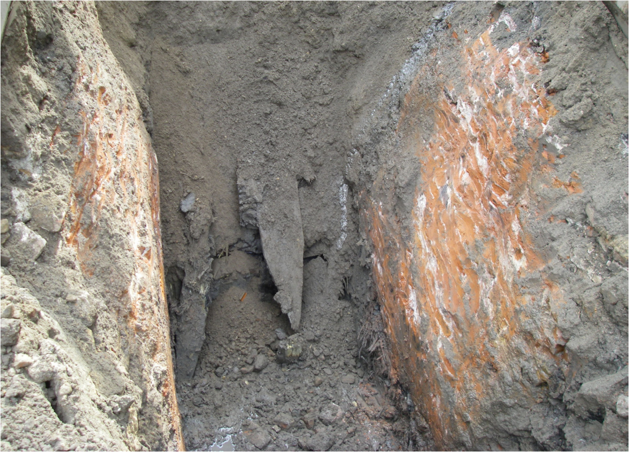
Figuur 4.23. De westelijke havenmuur S6.6 net nadat de muur machinaal is doorbroken. Onder de weggebroken muur komen aangepunte funderingspalen tevoorschijn.
