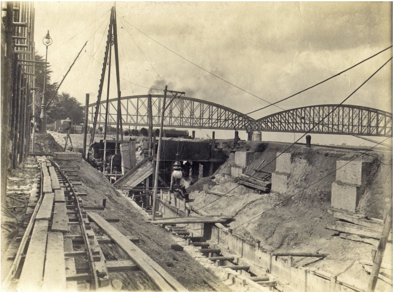
Figuur 2.31. Werkzaamheden ten behoeve van de bouw van de elektriciteitscentrale (1908) (RAN, foto F1862). Op de foto is ook de binnenzijde van het muurwerk van de Oude Haven nog goed te zien.
