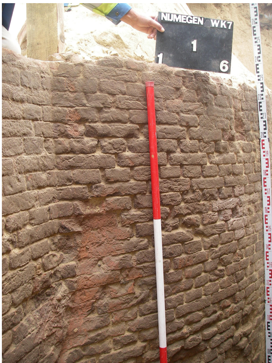
Figuur 4.4. Buitenaanzicht metselwerk van het havenhoofd S1.2 en aansluitende noordelijke haven-/kademuur S1.1.
