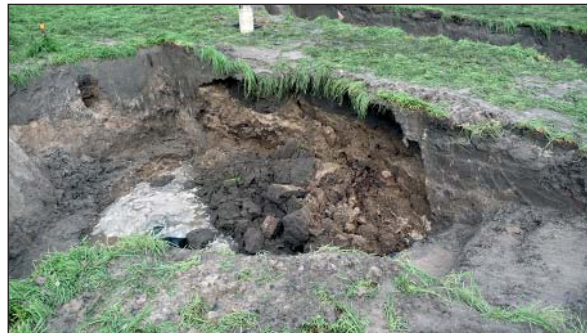
Fig. 3.2 Ingestorte putwand (Foto: K. Blok, RUG/GIA).
