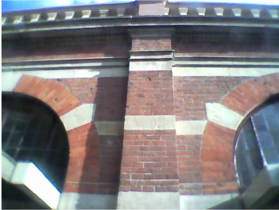
Figuur 6: Mogelijke kogelinslagen in de westgevel van het Muis Sacrum.
