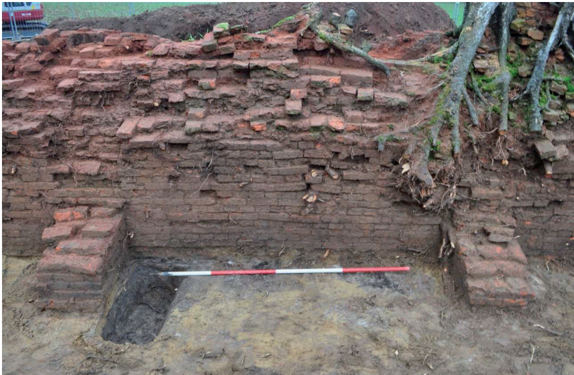
Figuur 8. De vier steunberen aan de lange zuidzijde. Onder detail met bouwnaad van de steunbeer in de muur.
