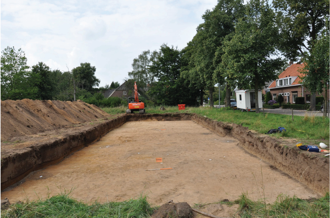
Figuur 11. Het plangebied tijdens de aanleg van de eerste put met op de achtergrond de Annahoeve.
