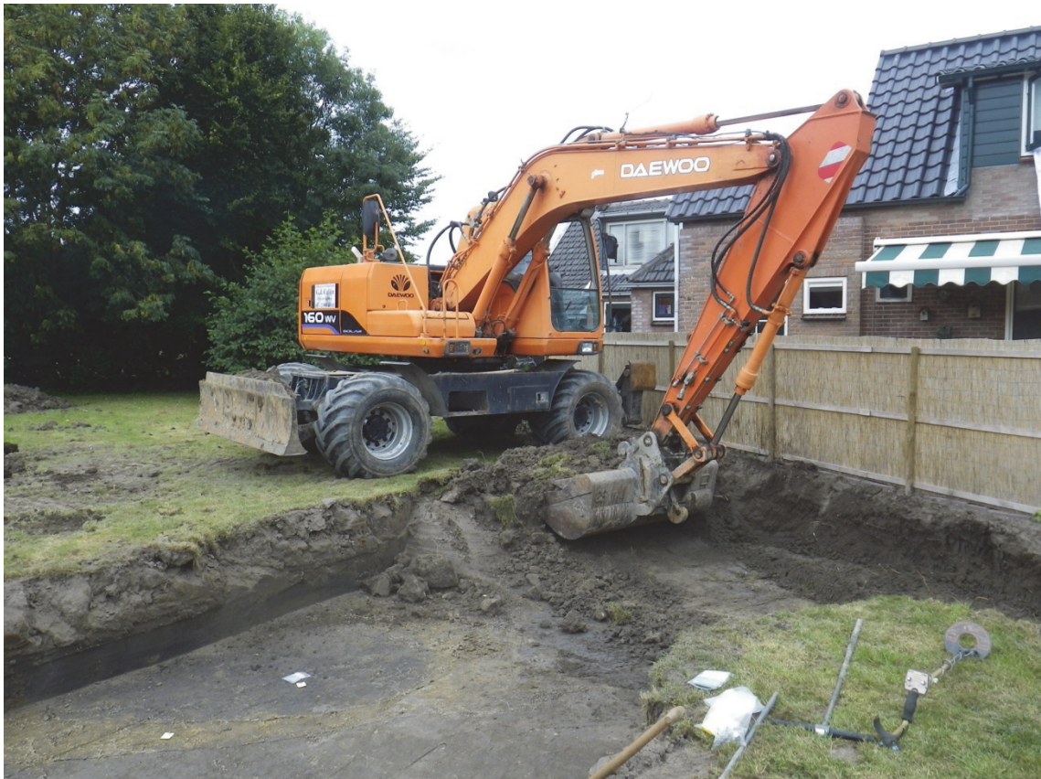
Fig. 4.1: De aanleg van het vlak in werkput 1 bij de start van de uitbreiding.
