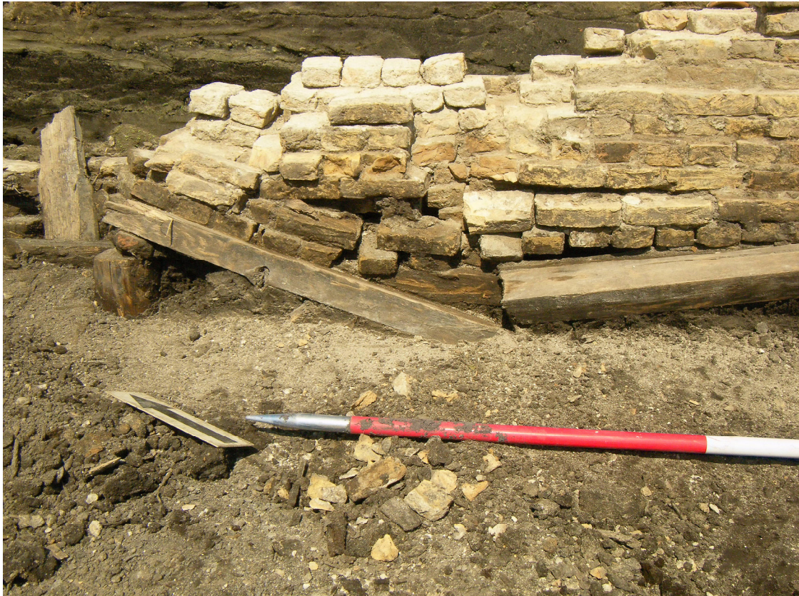
Figuur 24. De verzakte fundering van de wagenschuur.
