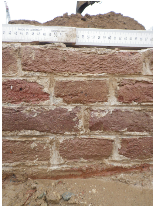
Afbeelding 13. Gedagde voegen in de vestingmuur.
