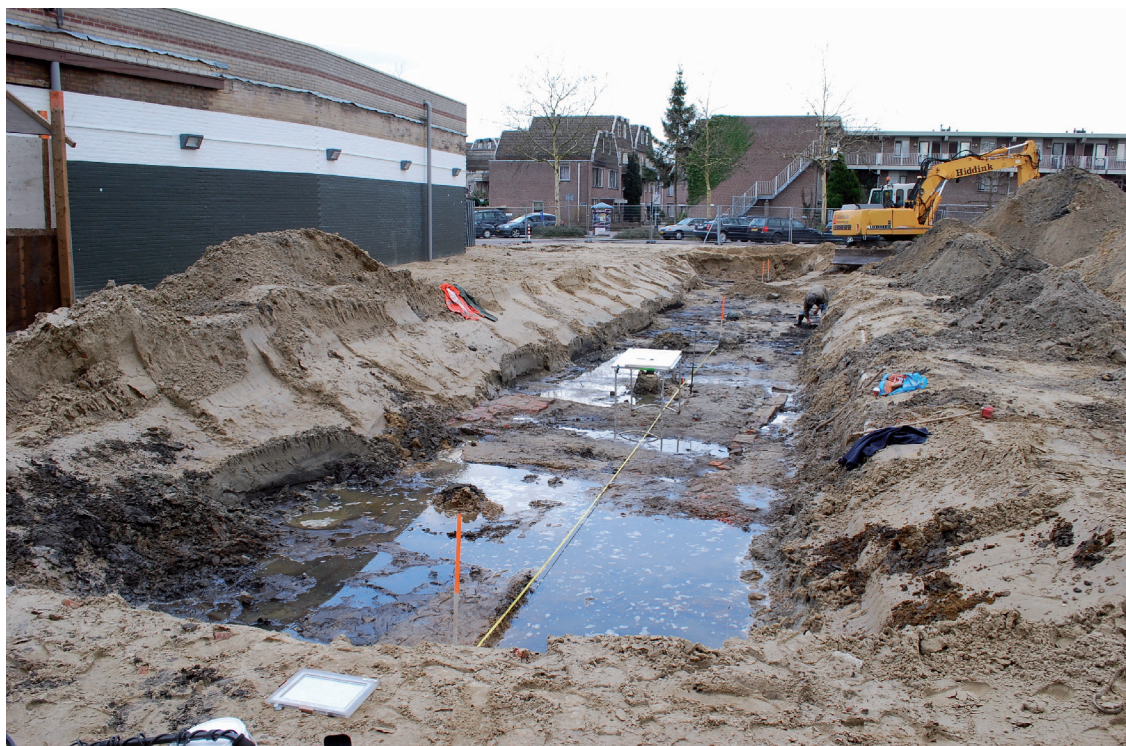
Figuur 6. Impressie van werkput 1: muurresten en grondsporen op de overgang van ophogingspakket en ongestoorde ondergrond.
