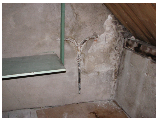
Afbeelding 73 Zicht op het oude Y-anker rechts in de topgevel tussen het achterhuis en voorhuis van Koningstraat 17.
