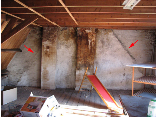
Afbeelding 113 De zolder van Klarestraat 2a met op de achtergrond de oude topgevel met sporen van oude daklijnen (zie de pijlen) en twee rookkanalen waarvan de middelste een oud kanaal betreft.
