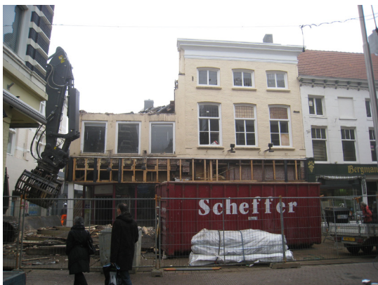
Afbeelding 12 Koningstraat 17 en 18 tijdens de sloop. Van nummer 17 is de verdieping reeds gesloopt, Koningstraat 18 staat nog volledig overeind.
