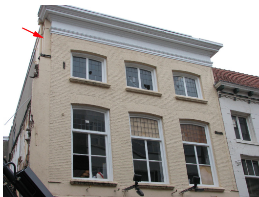
Afbeelding 76 De verdiepingen van de voorgevel van Koningstraat 18, kort voor de sloop. De rode pijl wijst naar de kopse kant van het na de oorlog verhoogde deel van de linker zijgevel.
