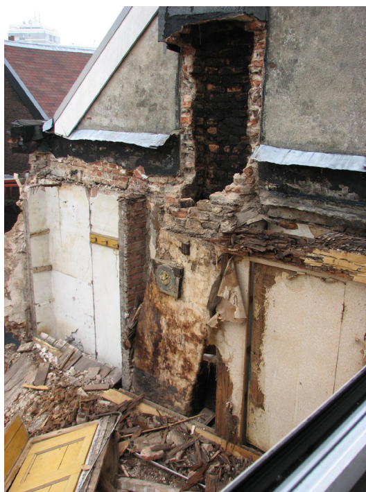
Afbeelding 59 De rechter zijtopgevel van het achterhuis van Koningstraat 17, nadat de tweede verdieping van Koningstraat 17 reeds is gesloopt. Het rookkanaal was nog van oude oorsprong, de gepleisterde geveltop daarboven is in deze vorm rond 1900 ontstaan.
