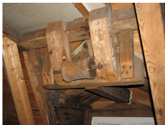
Afbeelding 136 De geleidingsconstructie van het touw van de hijsinstallatie in de kap van de dakkapel.
