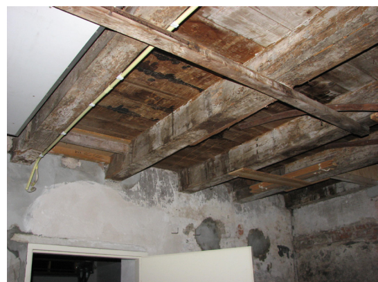
Afbeelding 128 Detail van de balklaag boven de begane grond in het achterste gedeelte van het pand.
