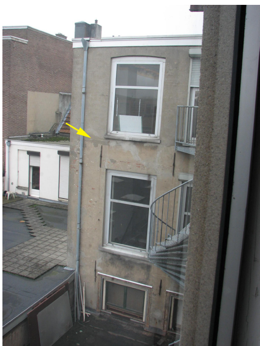
Afbeelding 79 De linker zijgevel van het achterhuis van Koningstraat 18 gezien vanuit de zolder van Klarestraat 2a. De naad tussen het oude werk en de ophoging is goed zichtbaar. De gele pijl geeft de plek aan.
