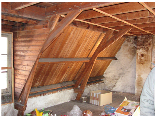
Afbeelding 112 De zolder met vroeg 20 e -eeuwse kapconstructie van Klarestraat 2a, gezien richting noordoosten.
