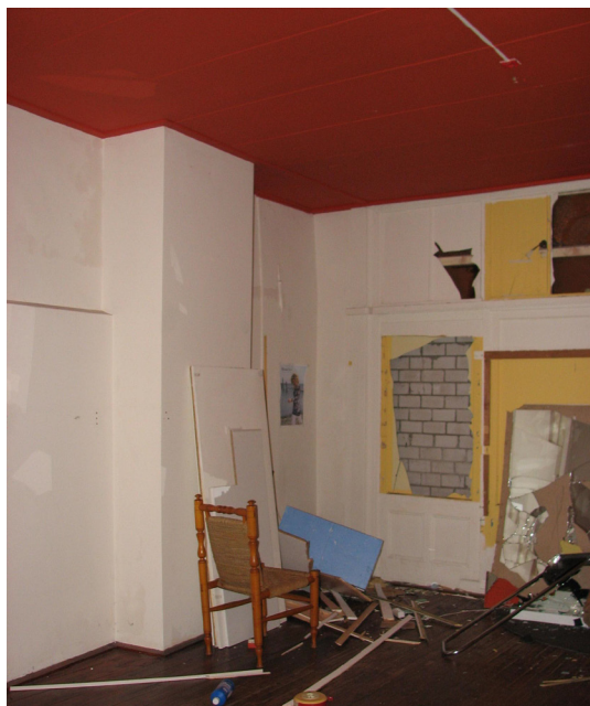
Afbeelding 107 Zicht in het voormalige achtervertrek met links de oostelijke zijgevel met het rookkanaal van de verder verdwenen stookplaats. Rechts achter is zichtbaar dat de voormalige tuindeurenpuis dichtgezet met kalkzandsteen.
