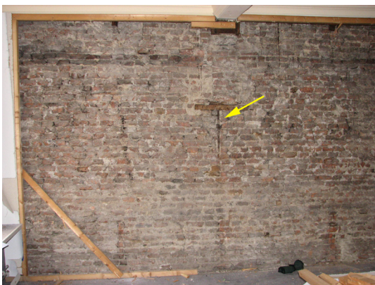
Afbeelding 87 Zicht op de linker zijgevel op de verdieping van Koningstraat 18. De gele pijl wijst naar een staafanker op 1,5 m boven de vloer. Dit anker behoort tot het buurpand Koningstraat 17.
