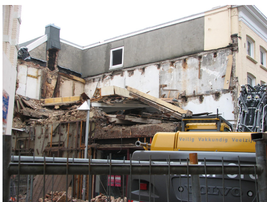
Afbeelding 75 Tijdens de sloop van Koningstraat 17 kwam de linker zijgevel van Koningstraat 18 vrijwel geheel in het zicht te liggen. Kort daarna werd ook Koningstraat 18 zelf gesloopt.
