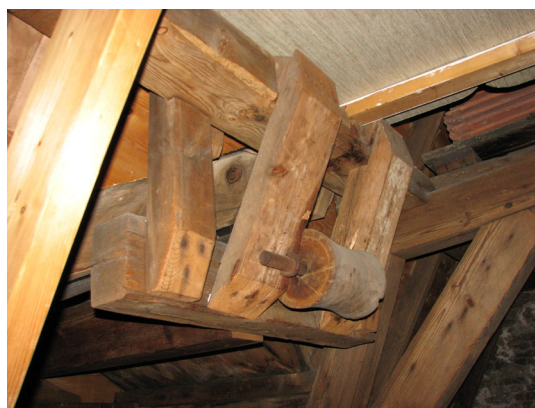
Afbeelding 143 De hijsinstallatie in de dakkapel, gezien vanuit het westen.
